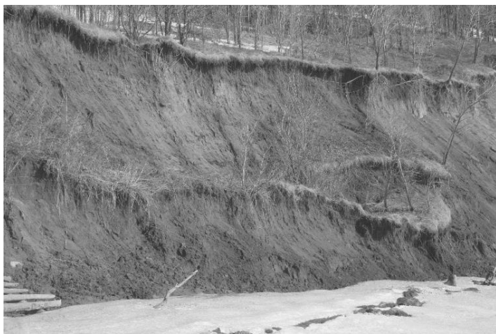
Рис. 9.2. Деляпсивный оползень. Берег Воткинского водохранилища.
