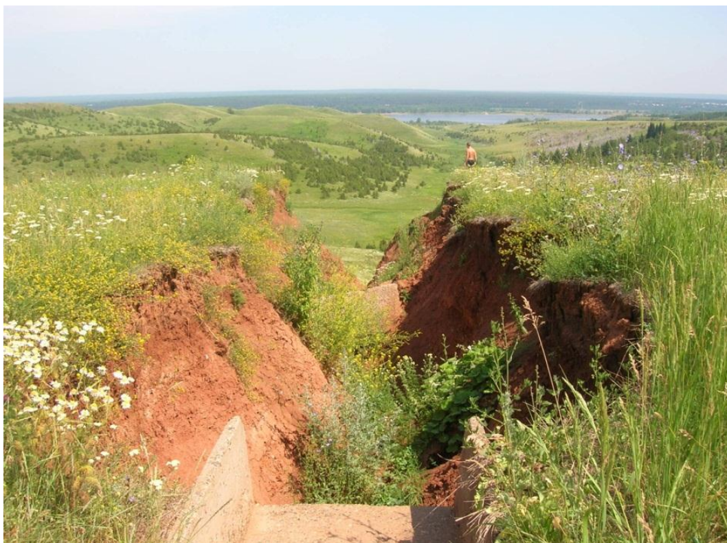
Рис. 4.3 Разрушение бетонного лотка придорожным оврагом ниже водопропуска на ключевом участке «Соколовка»
