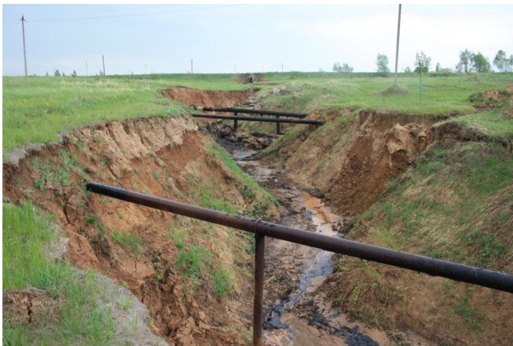
Рис. 4.7 Последствия катастрофического роста придорожного оврага ниже водопропуска весной 2011 г. на ключевом участке «Тарасово»
