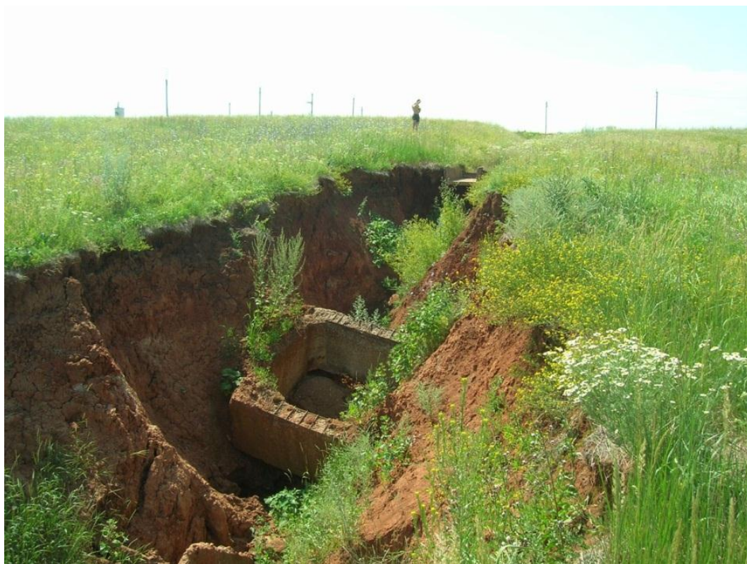
Рис. 5.10. Разрушение водоотводного бетонного лотка активно растущим оврагом ниже водопропуска у д.Соколовка Сарапульского района УР
