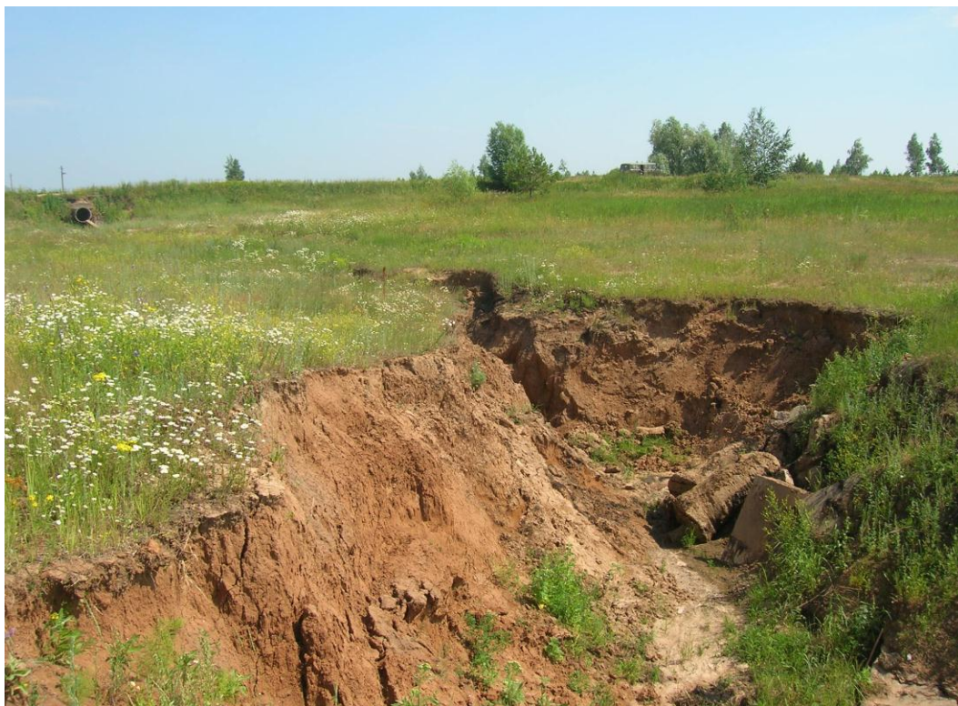
Рис. 2.3 Придорожный овраг ниже водопропускного сооружения у с. Соколовка Сарапульского района УР
