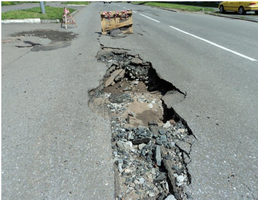
Рис. 4.26 Последствия интенсивных ливней 4-5 июля 2014 г. на ул. Коммунаров в Индустриальном районе г. Ижевска
