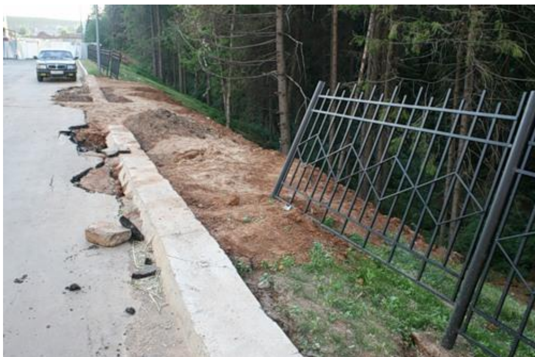
Рис. 5.13. Эрозионные процессы на плохо укрепленном склоне после окончания строительных работ в г. Ижевске
