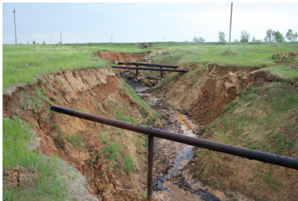
Рис. 4. Последствия катастрофического роста придорожного оврага ниже водопропуска весной 2011 г. на ключевом участке «Тарасово»
