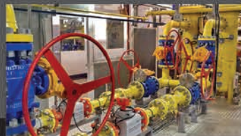
Блочные пункты подготовки газа
