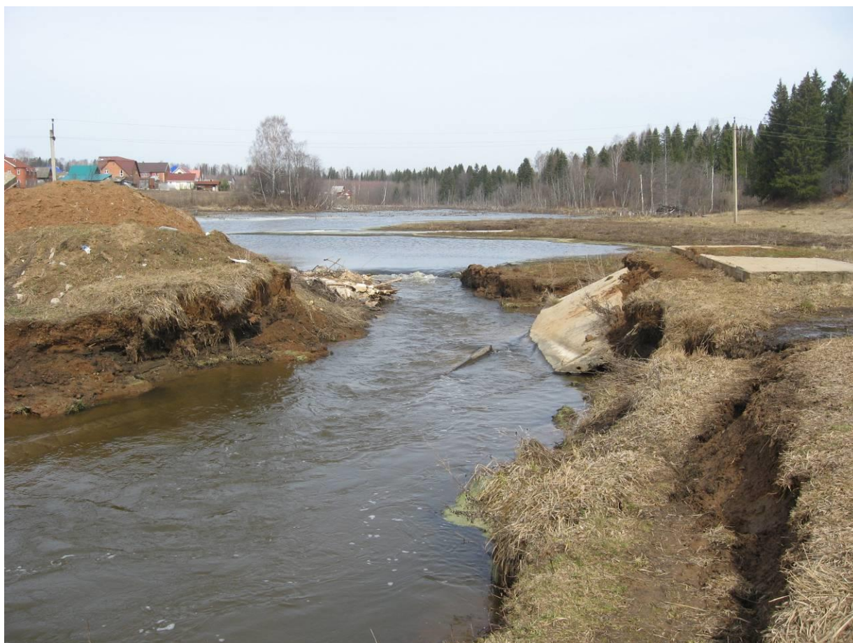
Фото. 2. Проран в теле плотины
