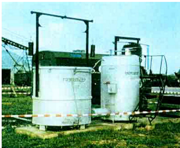
Рисунок 4.8 – Индивидуальная биогазовая установка ИБГУ-1 (на переднем плане – газгольдер, на дальнем – биореактор)
