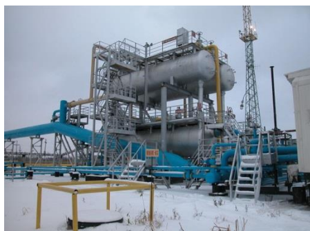
Рис. 1. Общий вид установки предварительного сброса воды
