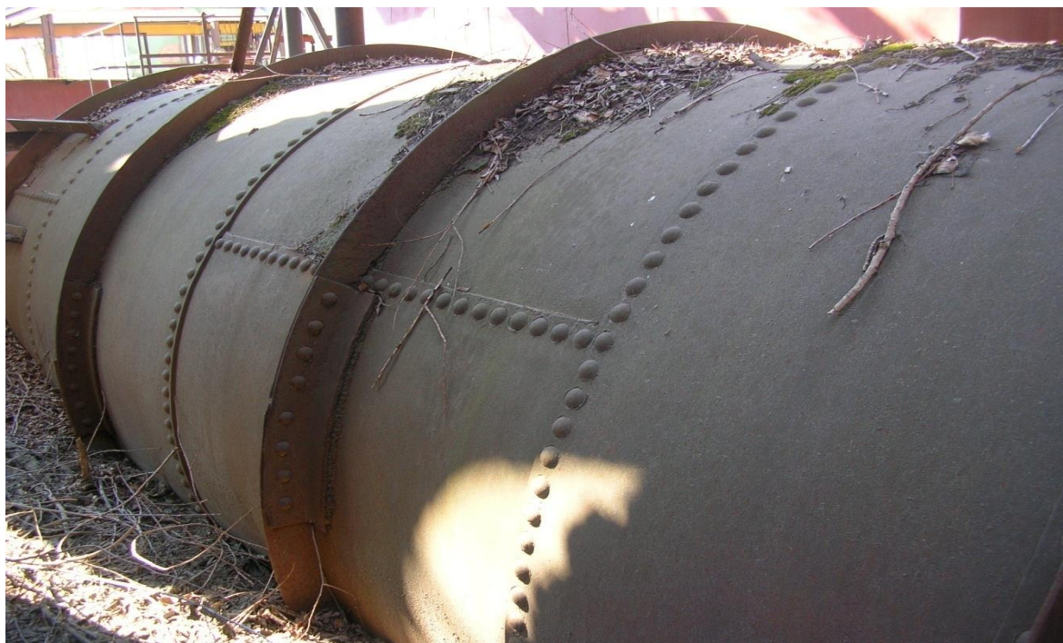
Рис. 4.26. Фото 2010 г. Сохранившийся участок (действующий) клёпанного водовода диаметром 2200 мм к Малой Водяной Турбины [В:8].
