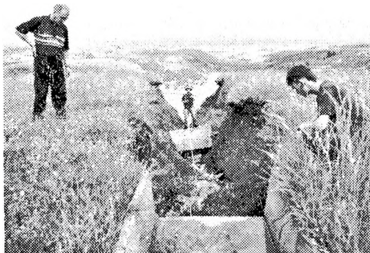
Рис. 7. Вершина активного оврага с разрушенными бетонными лотками на правом крутом склоне долины р. Кама у с. Соколовка Сарапульского района УР
